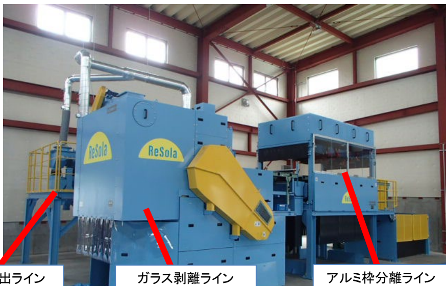
太陽光パネル処理専用プラント全景
